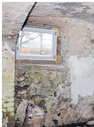
Seit neue Fenster in den Kellern eingebaut wurden, haben die Fledermäuse keinen Zugang mehr, sagt Ruth Greve.
